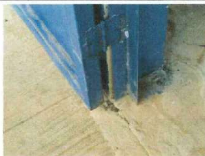
Foto 4: Se observa la necesidad de darle mantenimiento a las puertas del establecimiento educativo
