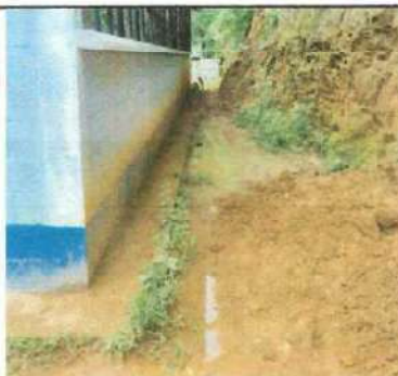
Foto 3: Se observa la necesidad de ampliar los canales de concreto alrededor de toda la escuela
