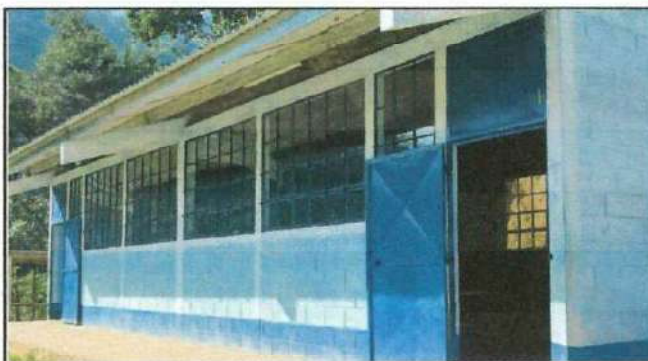
Foto 6: Se observa la necesidad de repellar y pintar las paredes del establecimiento educativo
